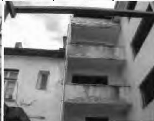
южна фасада –теч,паднала мазилка
